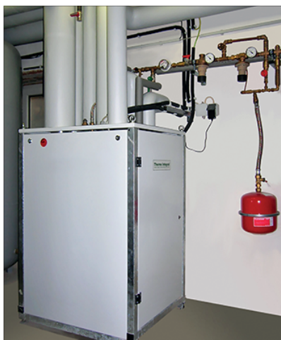
Bild 9. Smarte Kompakt-HAST in einem Mehrfamilienhauskomplex mit 60 Einheiten in Halle (Saale) mit einer Anschlussleistung von 600 kW
