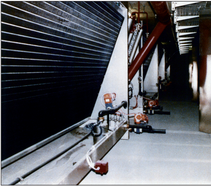
Bild 3. Im Gebäude eingebaute Hybridkühler.
